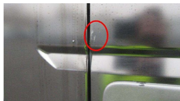
Fisură pe marginea ușii
