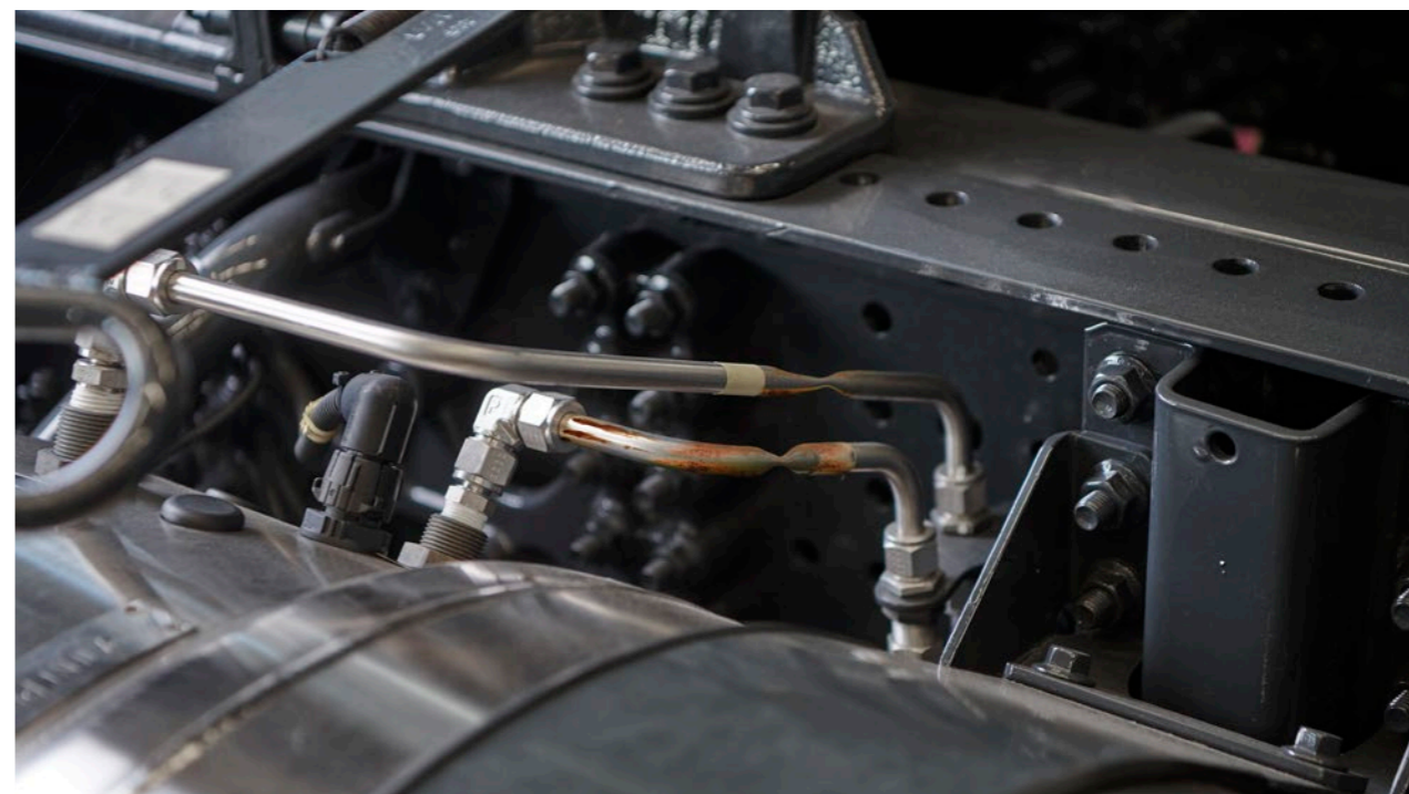
Rugină, lovituri, rupturi și/sau scobituri → taxă pentru înlocuirea conductelor rigide.
