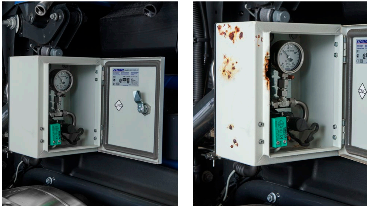
Rugină pe caseta de protecție pentru orificiul de umplere → notă fără perceperea unei taxe pentru deteriorare.
