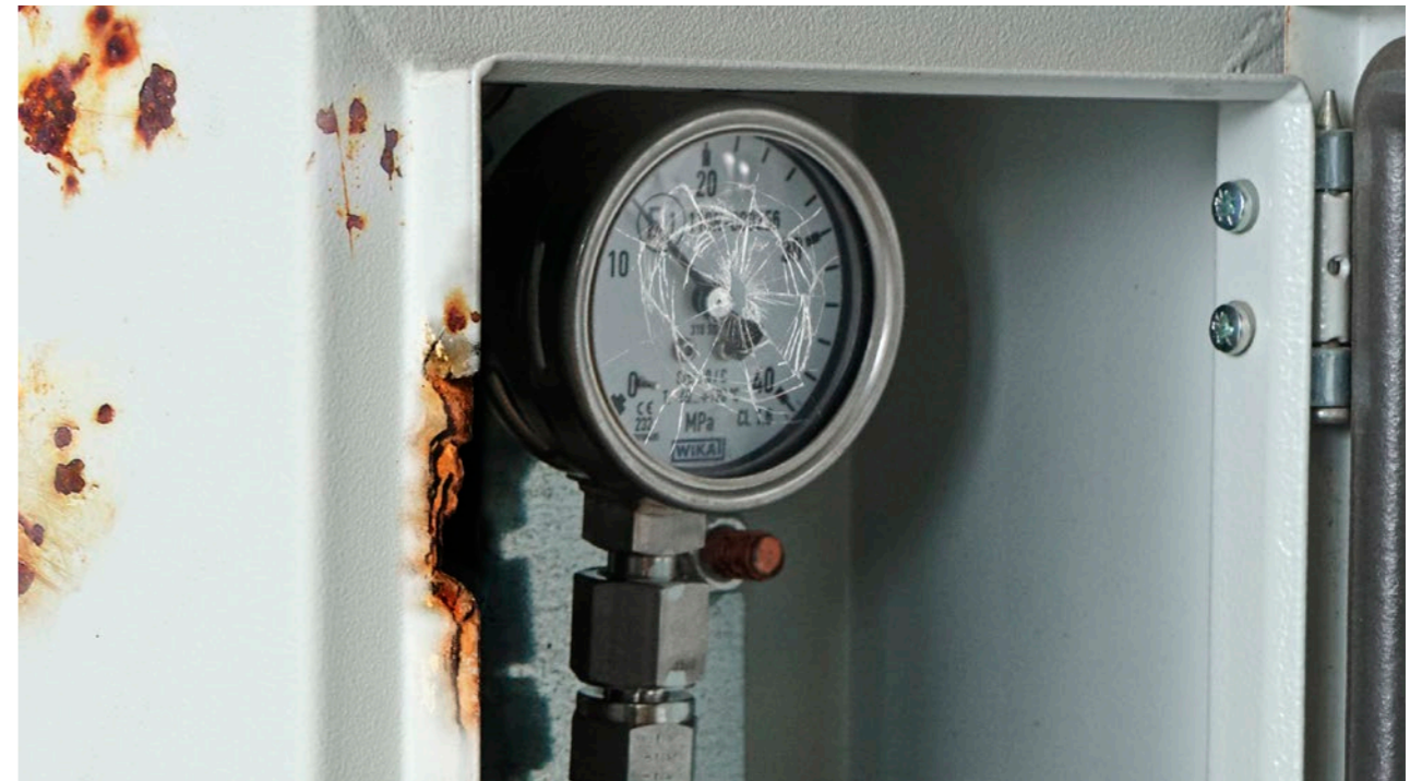
Cheie lipsă a casetei de protecție, recipient de GNC sau manometru deteriorat → taxă pentru înlocuirea întregii casete.
